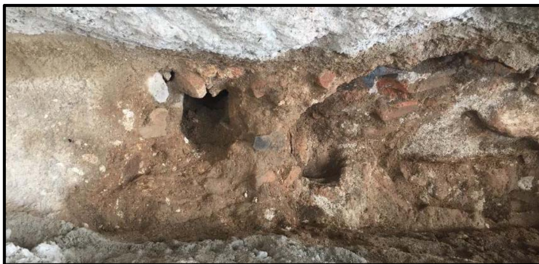
Foto 7: zona de la volta rebentada pel tub de servei. El forat dona directament a l'interior del rec.
