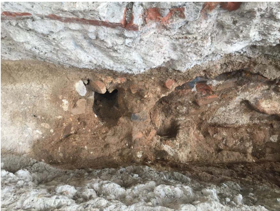
Foto 43: volta destruïda per el pas d'un servei ara en desús.
