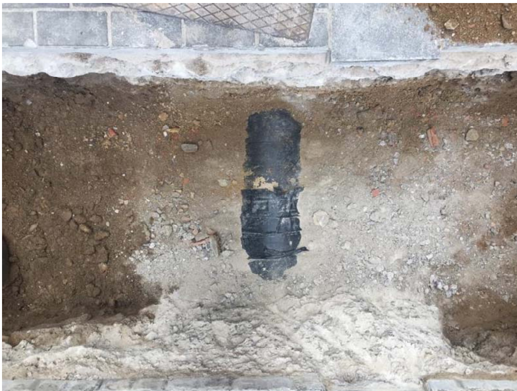
Foto 19: troballa de la volta de claveguera ja protegida en una obra anterior.
