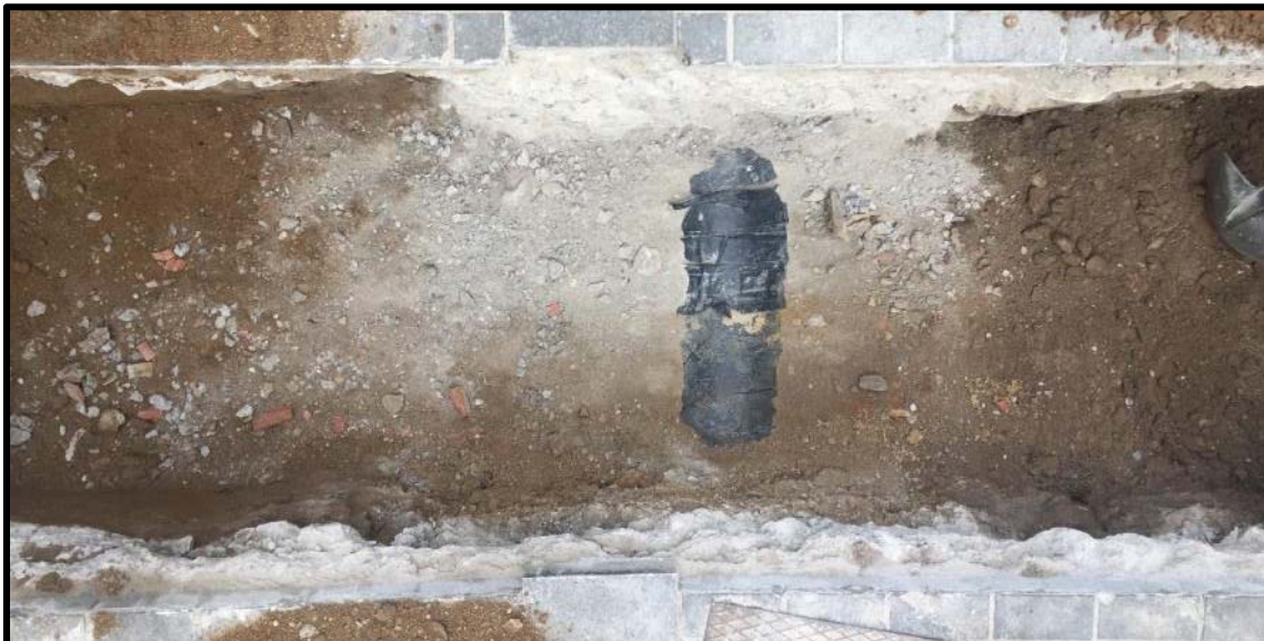
Foto 2: rasa 2. Cota màxima de rebaix de la rasa, moment en que sobresortia la volta de la claveguera protegida amb plàstics.
