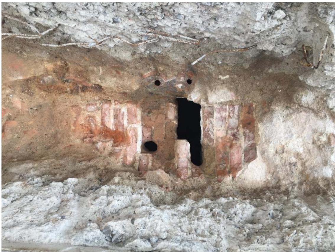
Foto 45: part de la volta del rec trencada pel pas del servei en desús.
