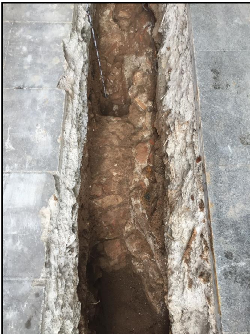
Foto 8: ala de la volta del rec i paret de l'estructura.
