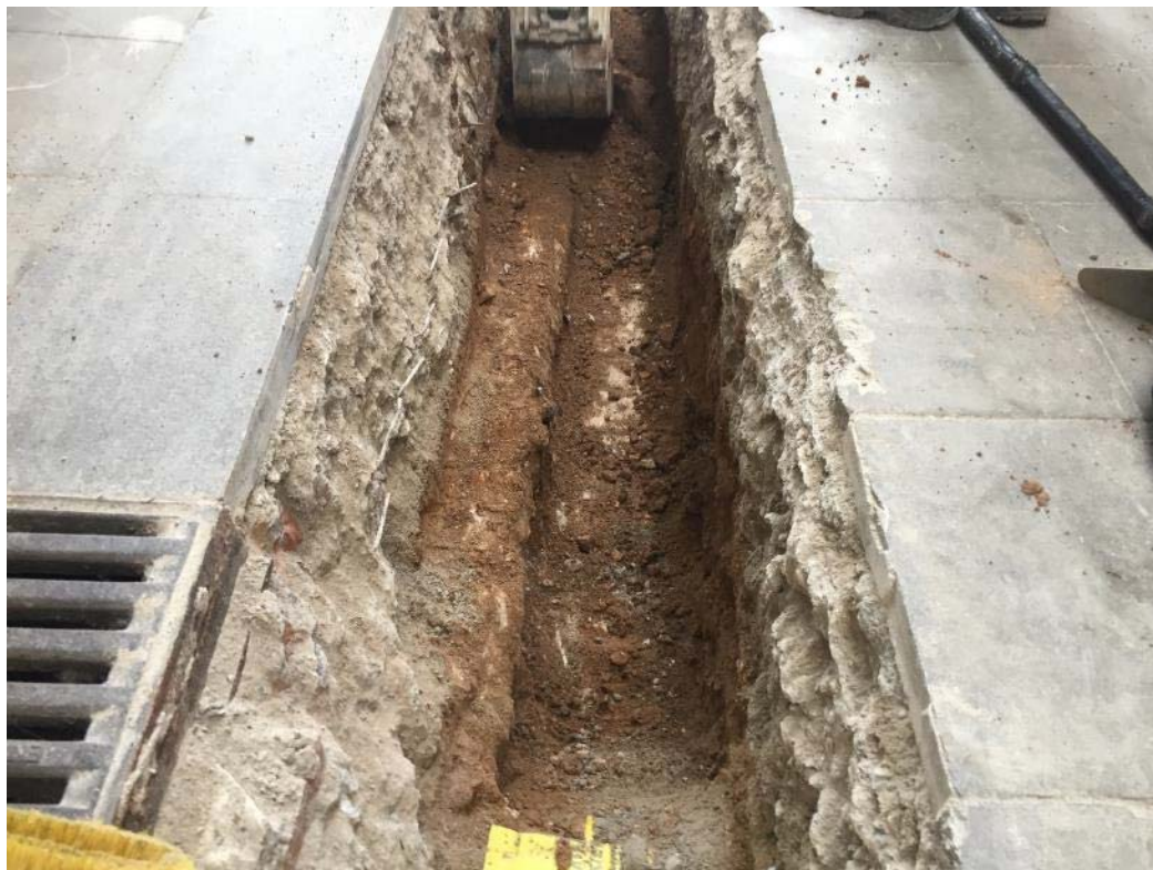
Foto 32: servei en desús passant per sobre de l'ala de la volta del rec.
